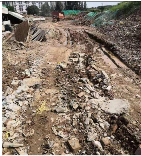
临时道路未硬化
